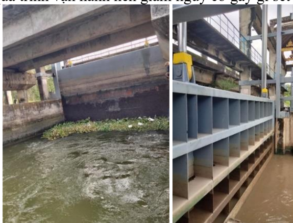
Hình 11. Cống Số 2 vận hành kịp thời để điều tiết nước.
